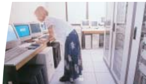
Serveurs de données, unités de stockages, éléments de back-up, routeurs...
