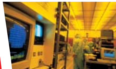
Equipements de fabrication en salle blanche, lithogravure, purification d'air, pompes pour circuits de fluides...
