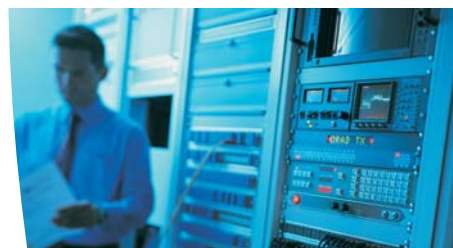
Intégration dans les racks haute densité.
